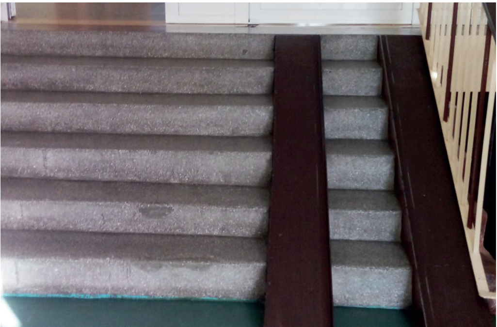
Wizytowany lokal wyborczy mający status dostosowanego do potrzeb wyborców niepełnosprawnych. Uwagę zwraca m.in. brak właściwego oznaczenia krawędzi stopni schodów. (Fot. BRPO).
