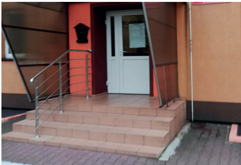
Wejście do wizytowanego lokalu wyborczego mającego status dostosowanego do potrzeb wyborców niepełnosprawnych. Uwagę zwraca m. in. brak podjazdu oraz oznaczenia krawędzi stopni (Fot. BRPO).
